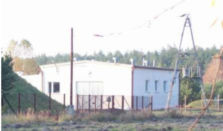
Stacja uzdatniania wody zaopatrująca pobliskie wsie w wodę pitną
